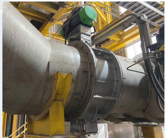
• FÁBRICA DE CELULOSA, CHILE. Dampers en chimenea de caldera recuperadora.
